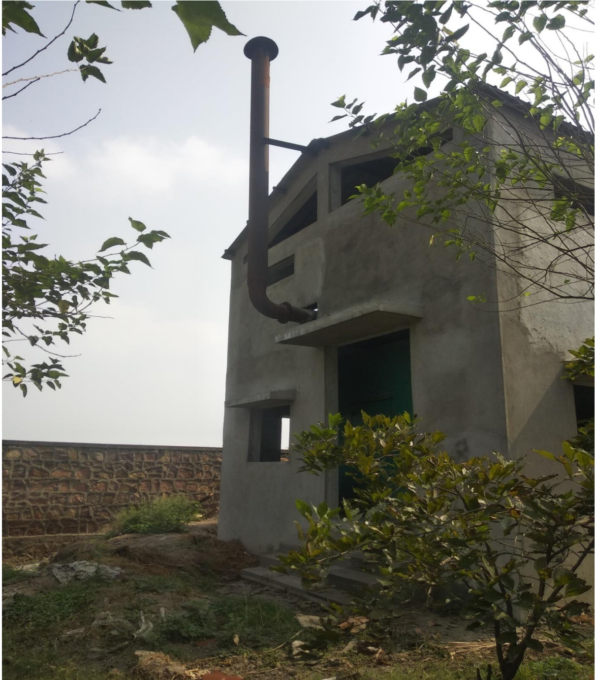
320 KVA DG set Chimney
