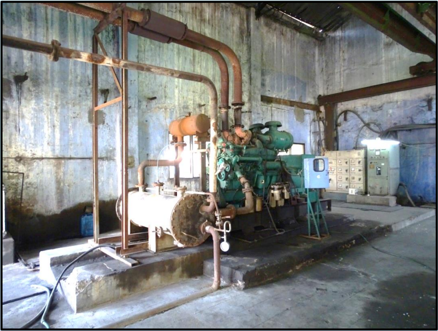
↓ 590KVA DG set
