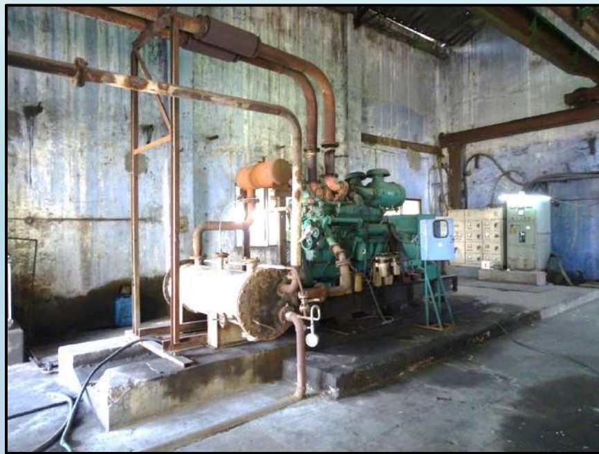
↓ 590KVA DG set
